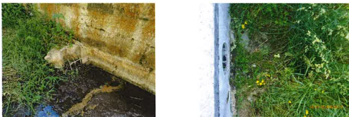
Figure 5 : Photo de la configuration des sorties du bassin A gauche : vidange du bassin (250 mm) A droite : forage du trop-plein (400 mm) – indiqué par une flèche
