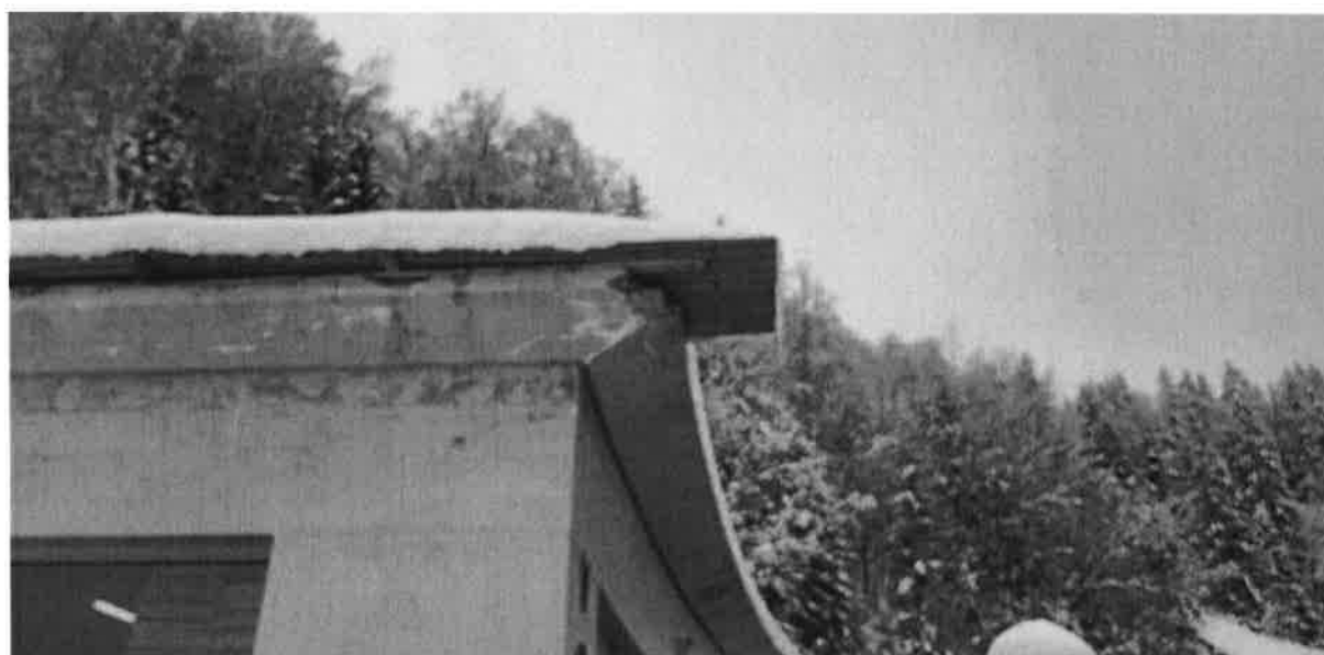
Situation actuelle, le parapet est recouvert d'une tôle provisoirement afin de diminuer la détérioration du béton.
